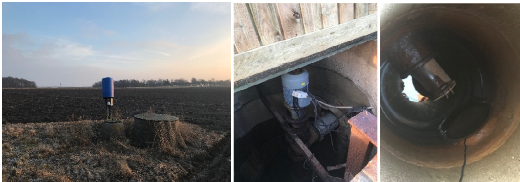
Figur 17: Den nuværende pumpebrønd og klapbrønd ved Skælskørvej.
