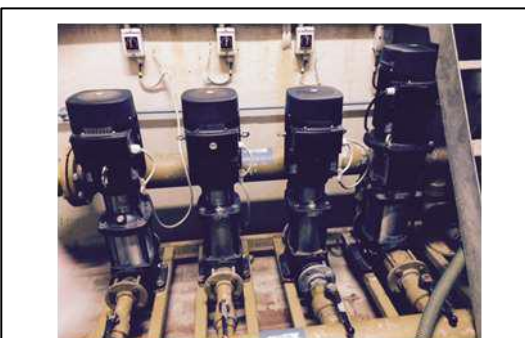
Pumper ud fra vandværket
