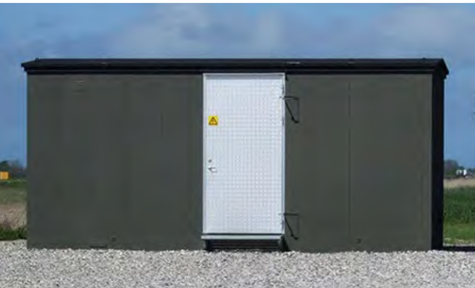
Figur 2.4. Koblingsstationer (forventet udtryk) i anlægget (solcelleanlæg ved Lerchenborg, CGE).
