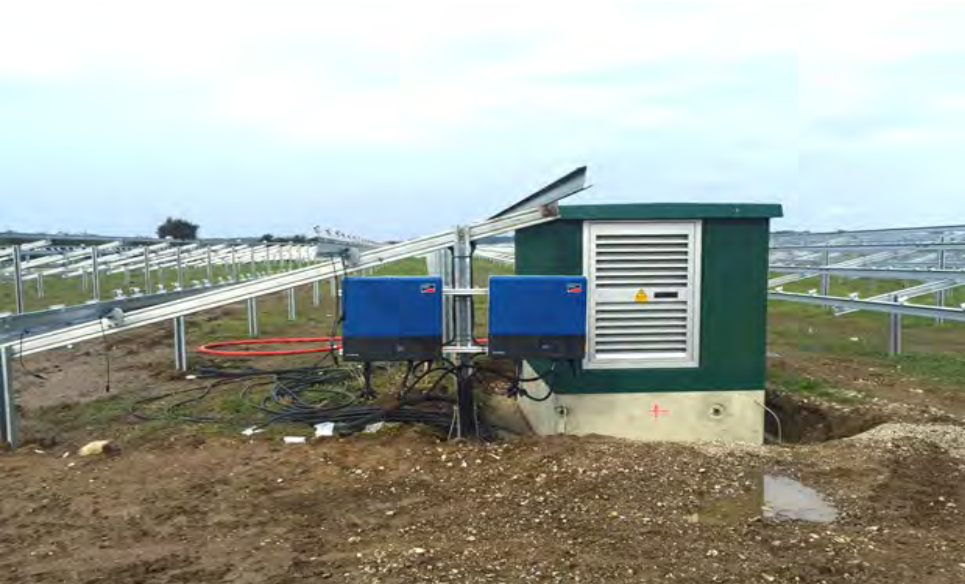
Figur 2.3. Invertere (blå) og step-up transformere i anlægget (solcelleanlæg ved Lerchenborg, CGE).
