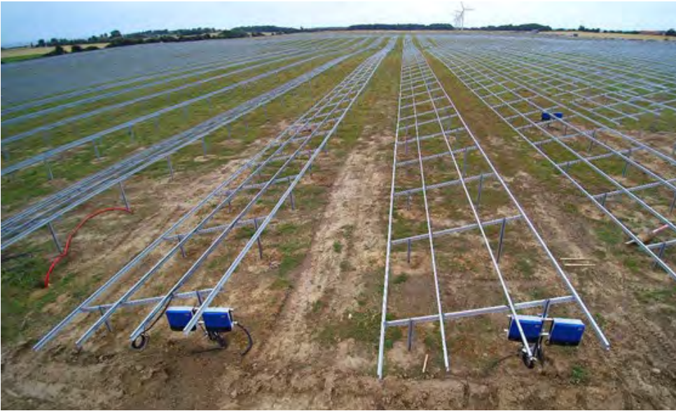
Figur 2.2. Aluminiumsstativer påsat invertere (blå) (solcelleanlæg ved Lerchenborg i Kalundborg Kommune, CGE).
