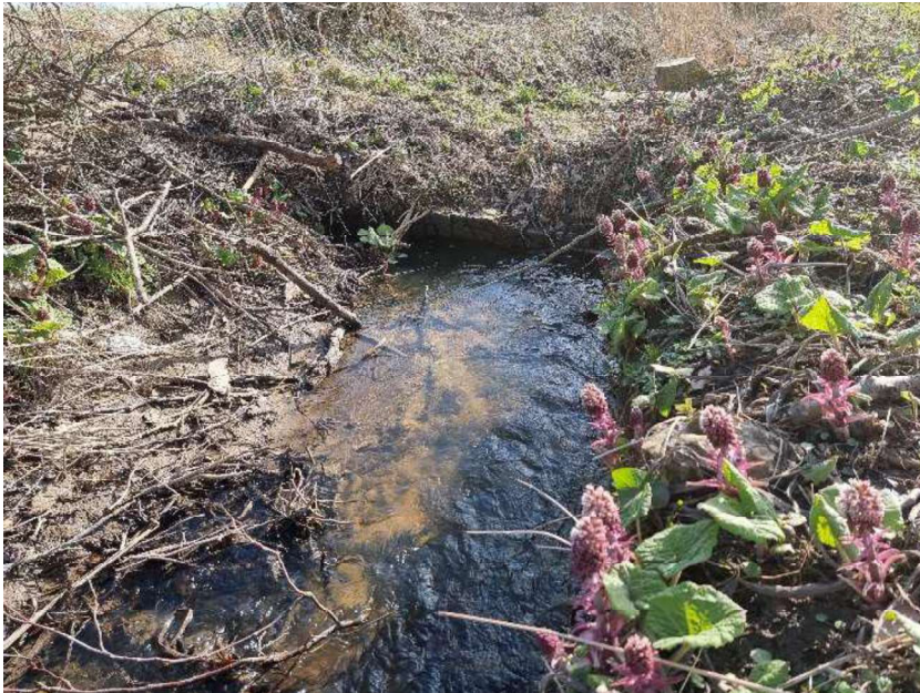
Foto 1: Den sammenstyrtede spang. Fra ansøgningsmaterialet.
