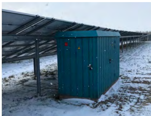
Figur 1-4 Eksempel på en teknikbygning, her en typisk transformerkiosk, der placeres bag solcellepanelerne.
