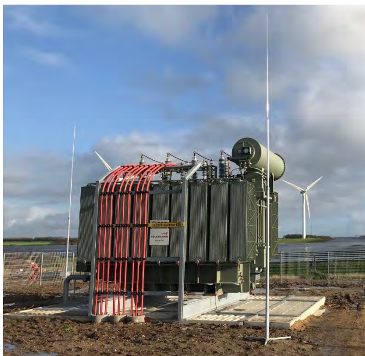
Figur 1-6 Eksempel på power-transformer, som typisk placeres midt i anlægget langt væk fra naboerne. Bemærk i øvrigt de tynde lynafledere. Kilde: European Energy.
